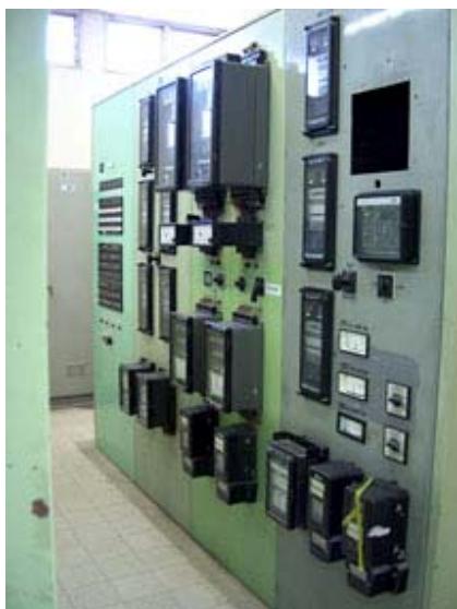
Figure A3-3: Old EM Protection Panel
