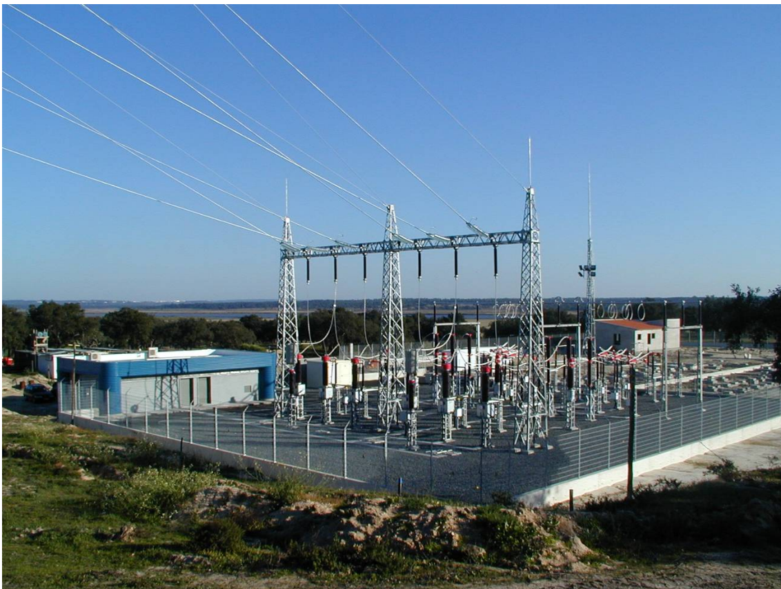
Monte da Pedra Substation
